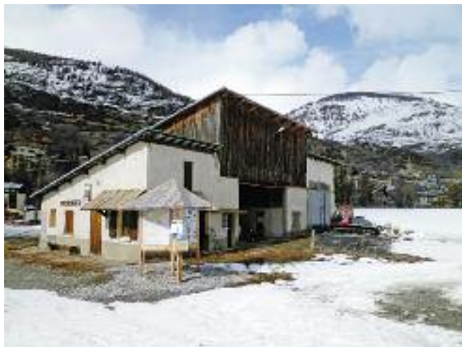
La gare désaffectée du télésiège d'Aiguilles occupe une place centrale dans la reconversion du site.
